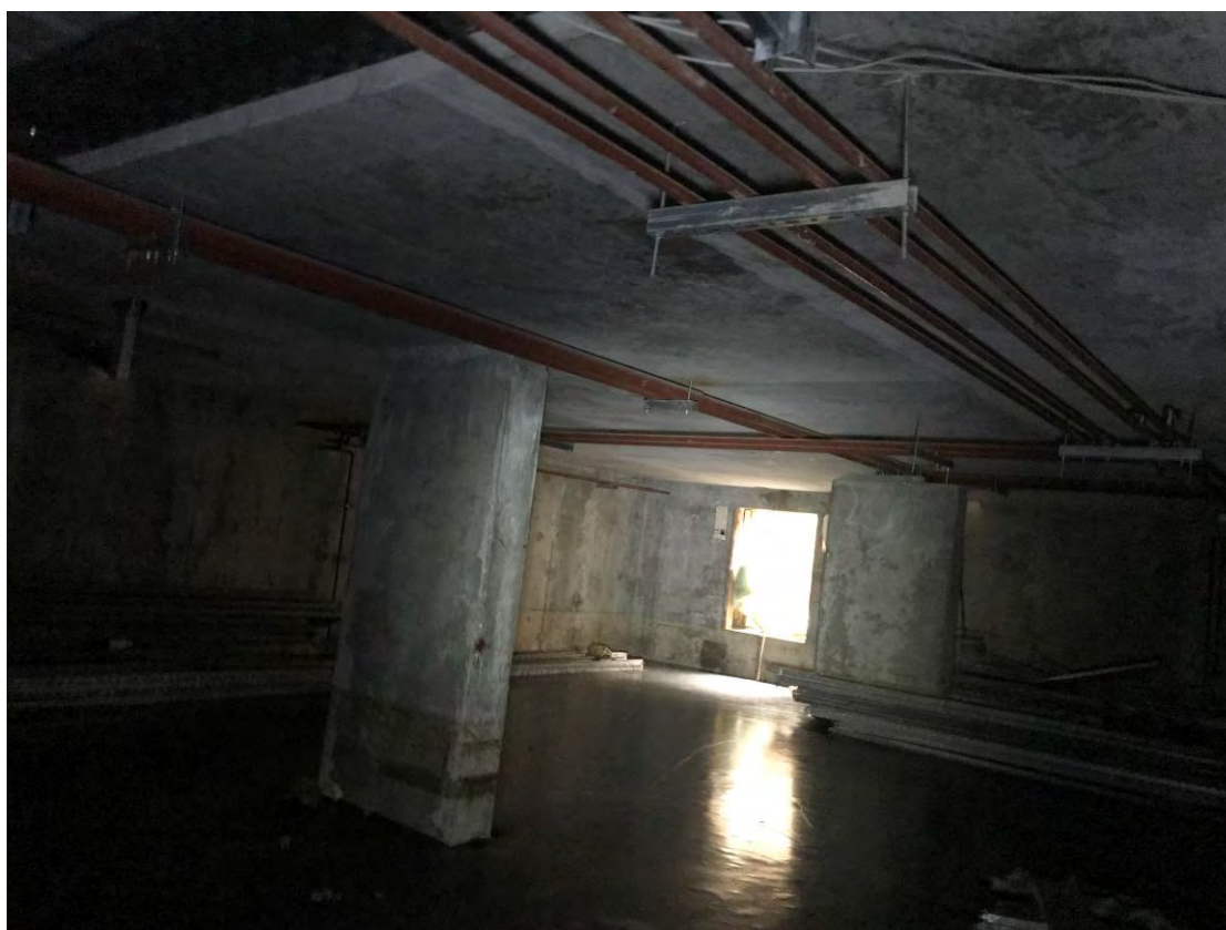
Рис. 3.1.8. Замачивание верхней поверхности фундаментной плиты с последующим замерзанием и фазового перехода воды в лед на высоту до 200 мм
