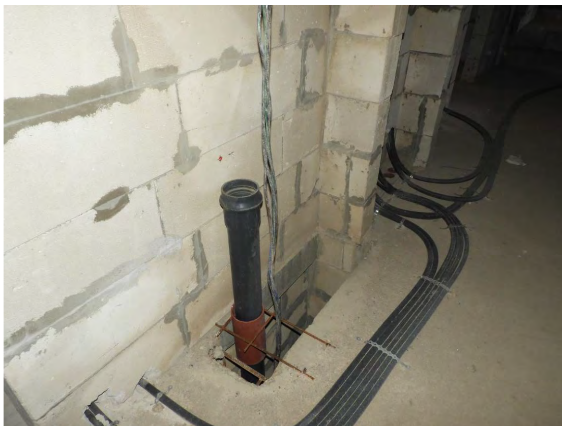
Рис. 3.7.2.4. Общий вид внутреннего водостока 3-го этажа в секции №1
