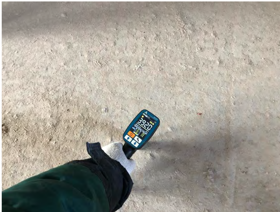
Рис. 4.3.1. Определение прочности бетона в монолитной железобетонной стене подвала ультразвуковым методом прибором UK 1401
