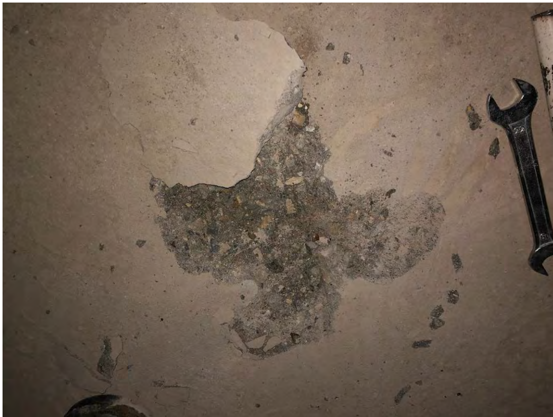
Рис. 4.2.8. Внутренняя область бетона после проведения испытаний
