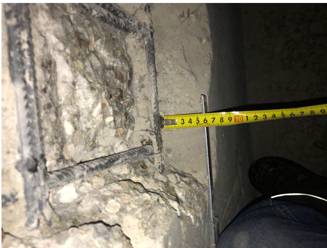
Рис. 3.2.8. Замер толщины защитного слоя бетона монолитной стены в уровне 2-го этажа по оси ДД между осями 3-4
