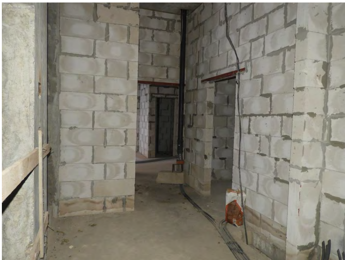
Рис. 3.7.2.2. Общий вид внутреннего водостока устроенного по временной схеме
