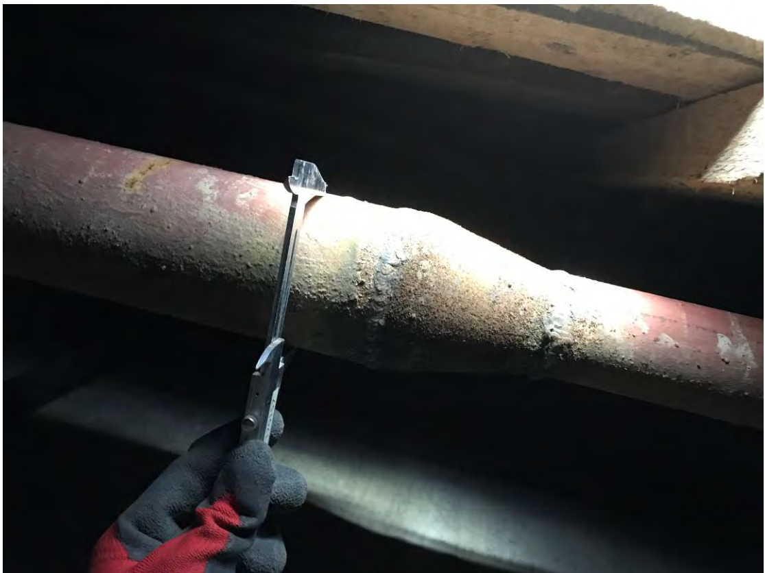
Рис. 3.7.3.3. Поражение коррозией трубопроводов и сварных швов.
