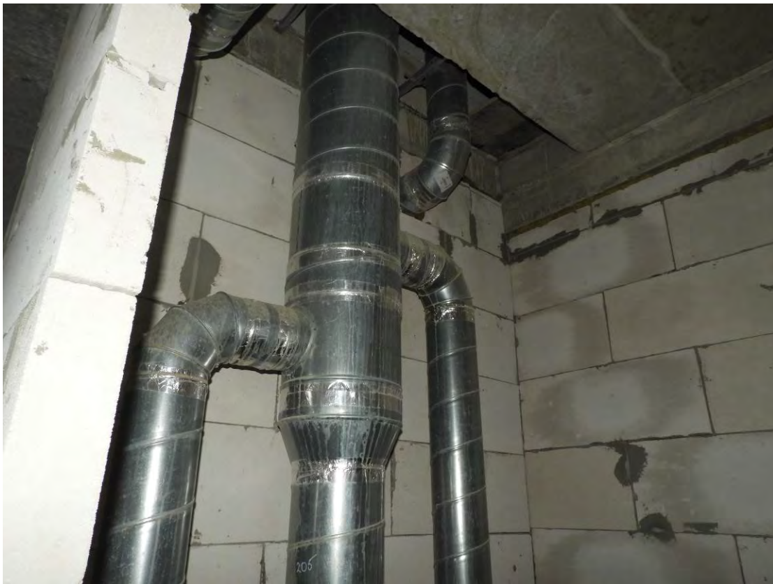
Рис. 3.7.3.4. Общий вид вентиляционного стояка
