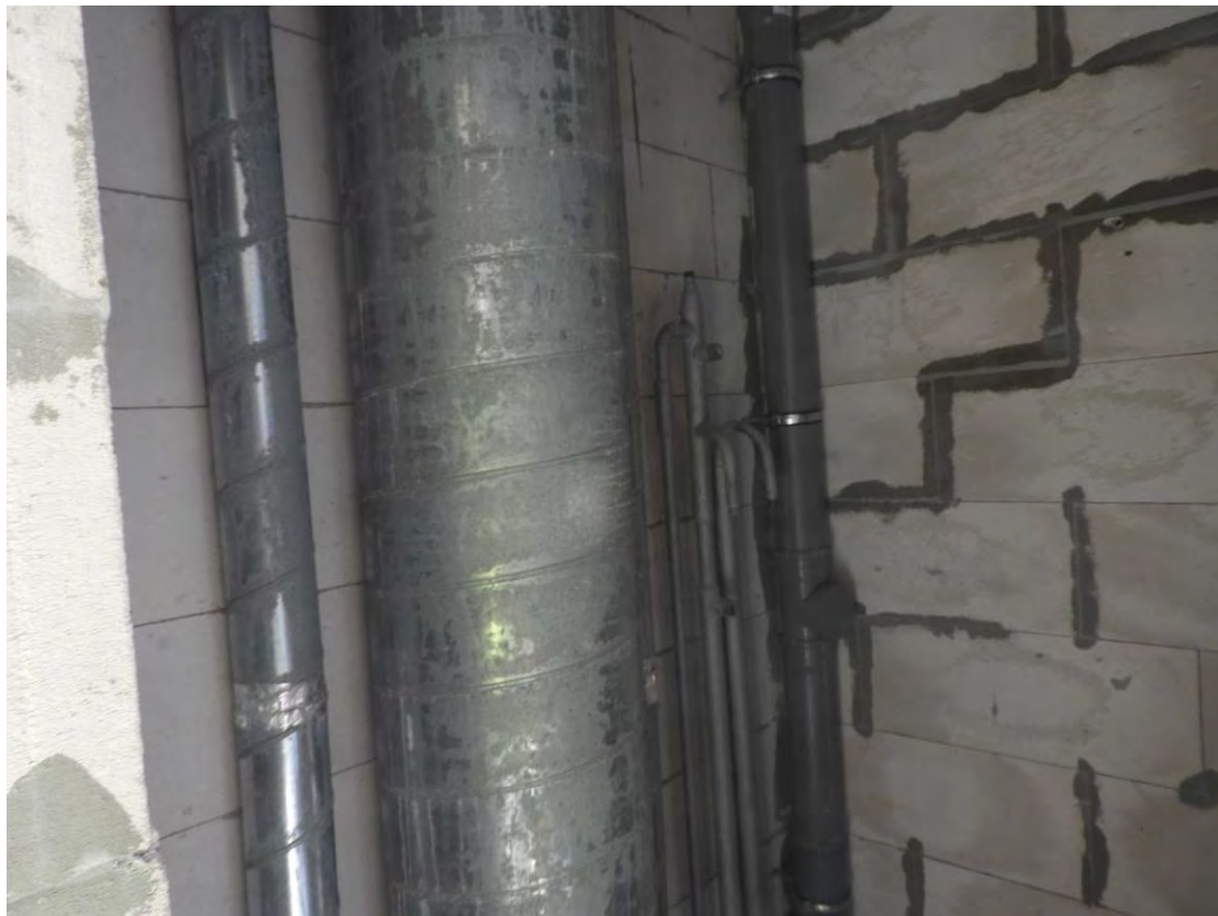
Рис. 3.7.2.1. Общий вид внутриквартирного стояка бытовой канализации секции 5
