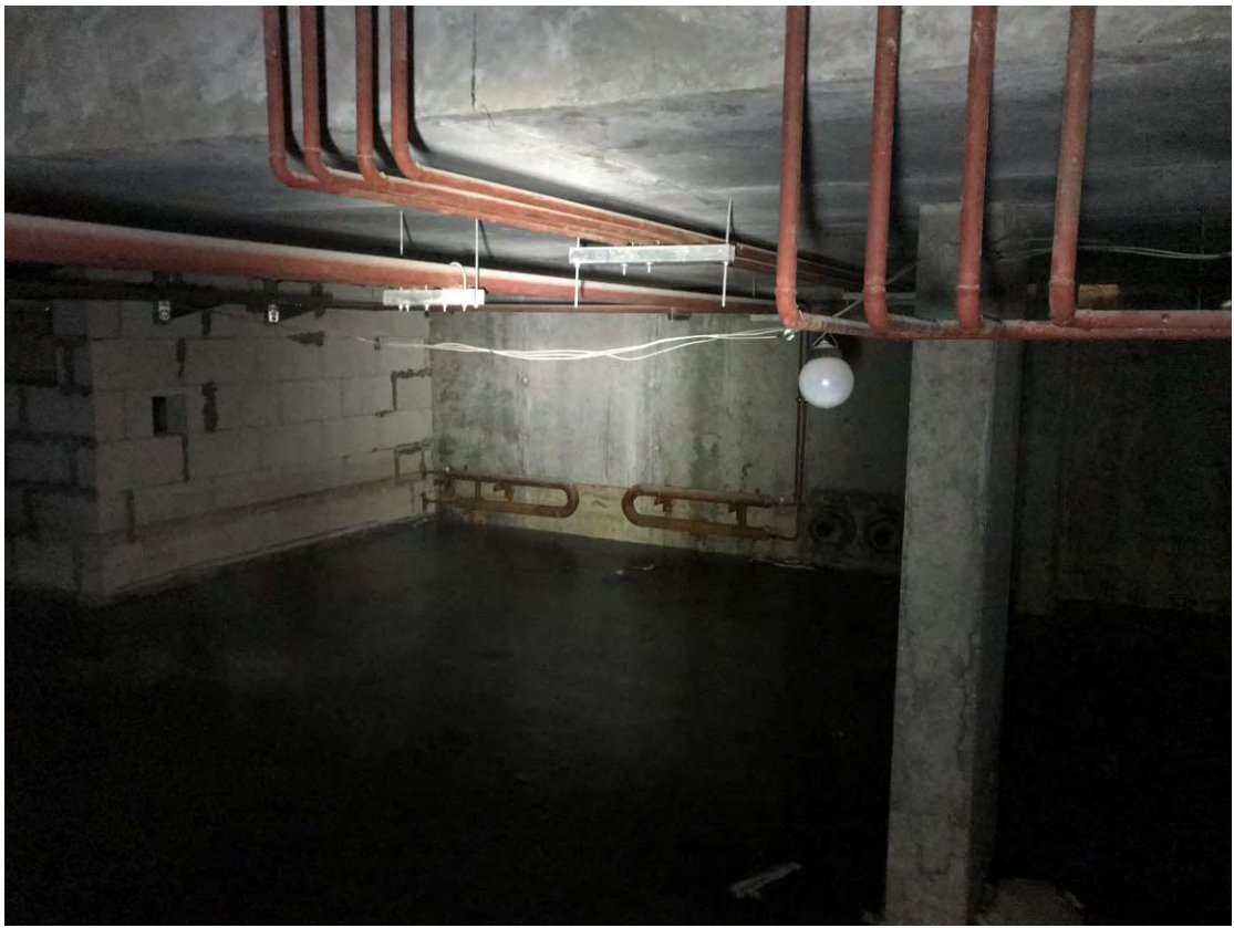
Рис. 3.7.3.2. Общий вид радиаторов отопления в подвале
